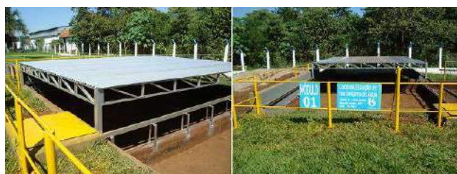
Figura 5. Cobertura móvel instalada no LD da ETA de Cardoso-SP. Fonte: Cordeiro et al. (2014).
