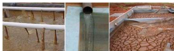
Figura 4. Leito de drenagem em escala real na ETA Cardoso – SP. Fonte: Fontana (2004).
